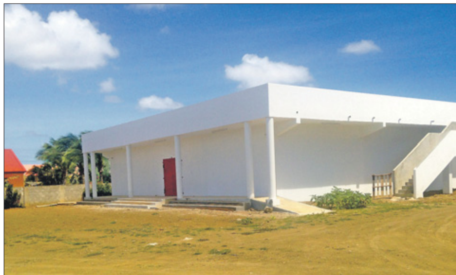
De supermarkt was al bijna klaar toen de bouw stilgelegd werd.
